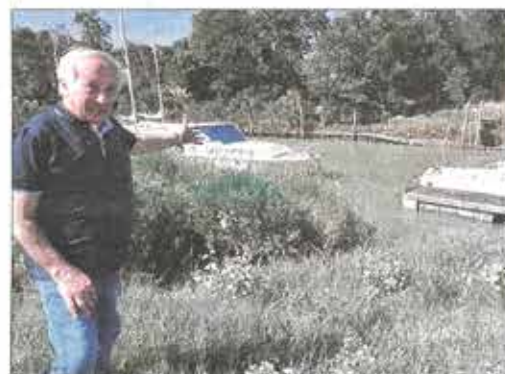
Gérard Roi fait constater les dégâts causés par les vagues, comme l'effondrement des pieux joints permettant de protéger les berges du port.
